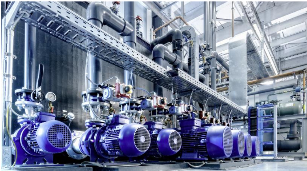
L&R Pumpen- tankanlage
