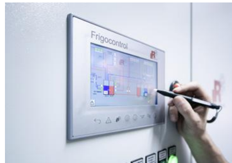
Frigocontrol-Steuerung mit Siemens SPS und Touchpanel
