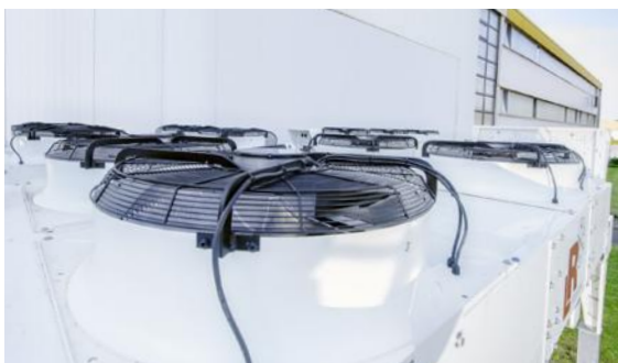
Luftgekühlte Kondensatoren mit energieeffizienten EC-Lüftern
