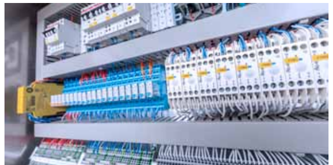
Elektro- und Steuerungstechnik gehören zu den Kernkompetenzen von L&R Kältetechnik.
