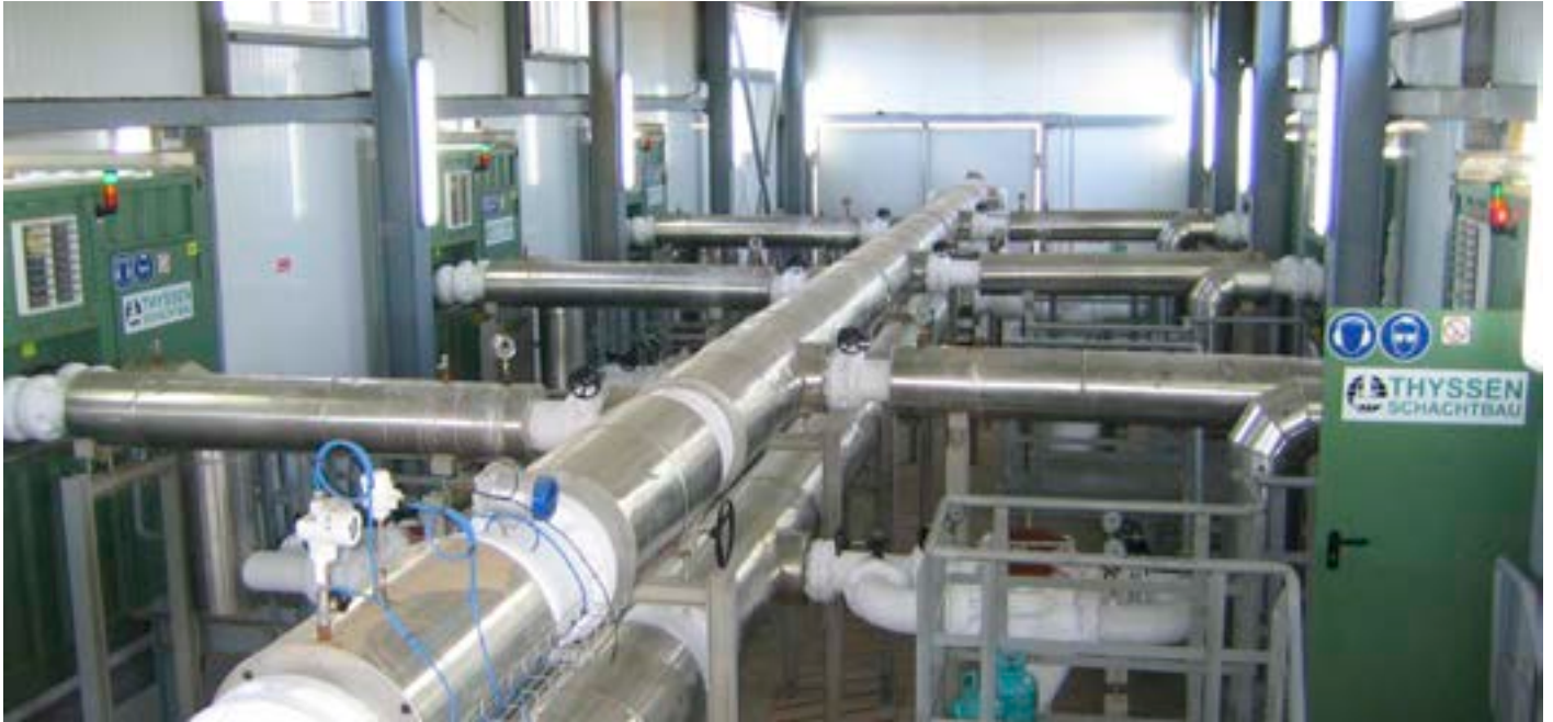
Von der Pumpenhalle zweigen mächtige Rohrleitungen zu den einzelnen Containern ab, in denen die Kälteanlagen untergebracht sind.
