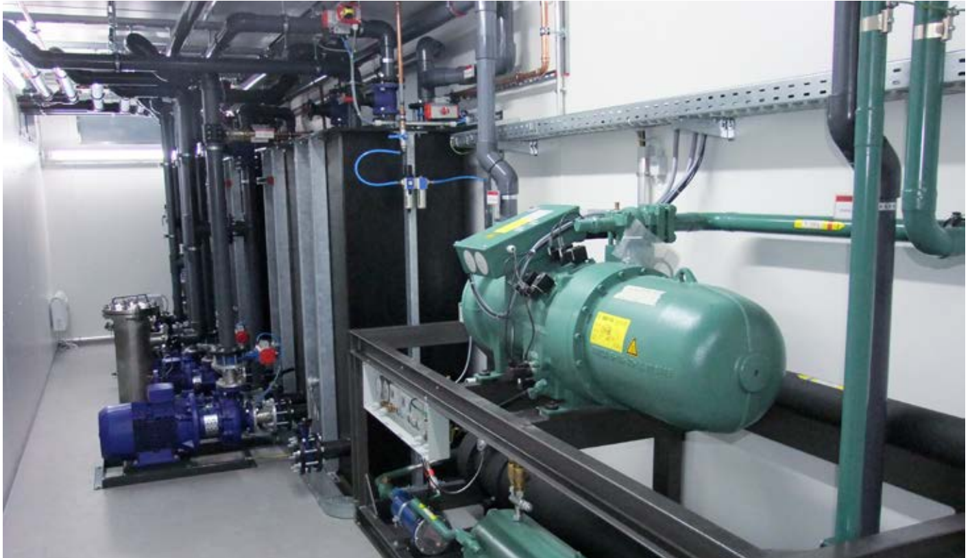
(1) Blick in den Container mit der Split-Kälteanlage für den Werkzeug-Kühlkreislauf.
