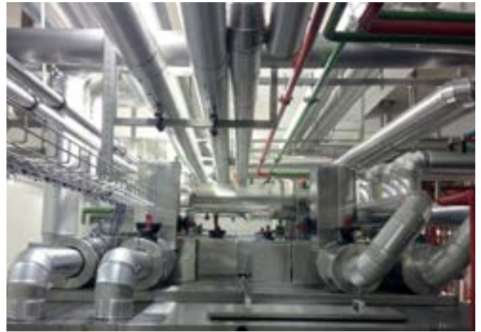
Beispiel einer Anlage in der Süßwarenindustrie in Süddeutschland
