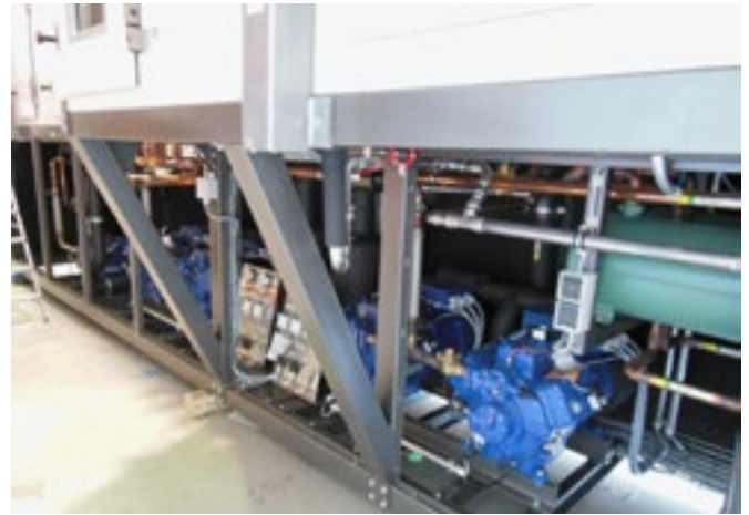
Blick auf die Verdichter im „Untergeschoss“ der Kälteanlage
