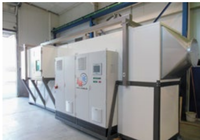
Die individuell projektierte L&R-Kälteanlage erzeugt trockene Luft für die Vermahlung von hochwertigem Pulverlack.
