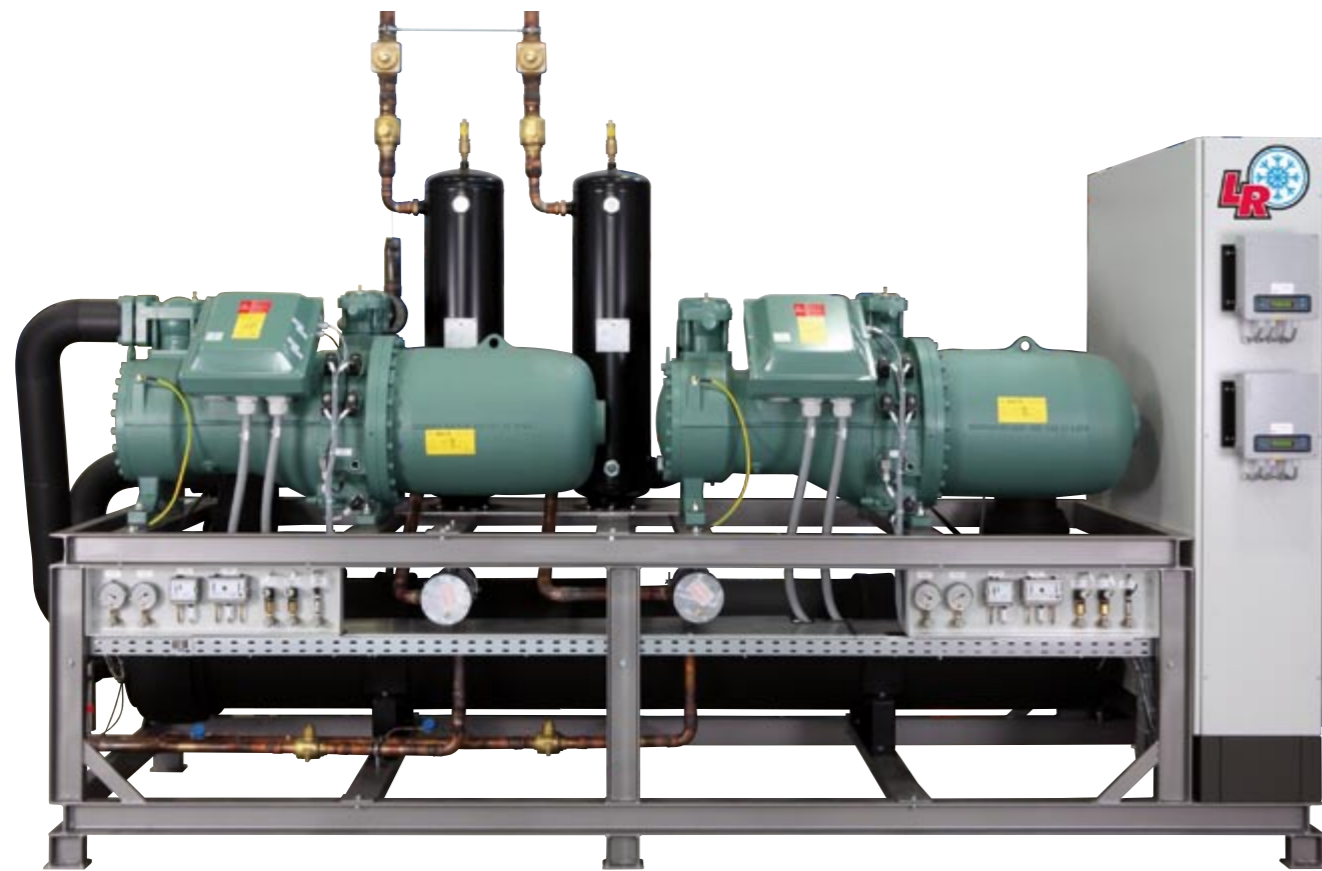
>> L&R-Kältemaschine mit Bitzer Schraubenverdichtern und „Vari-Kon“-Regelung
